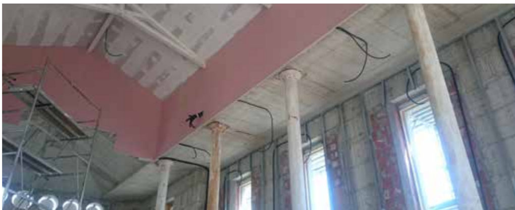
La posa dei pannelli in cartongesso per gli interni. A sinistra, la posa di pannelli radianti a pavimento.
